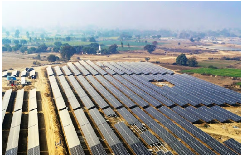
Das 75-MW-Solarkraftwerk Uttar Pradesh I ist das bislang Grösste, das ThomasLloyd in Indien gebaut hat.
